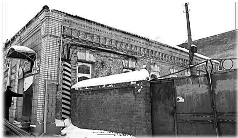
Фото 1. Спотворена будівля на вул. Б. Хмельницького (колишня вул. Бердичівська)
